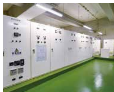
電気室 ELECTRICAL ROOM
