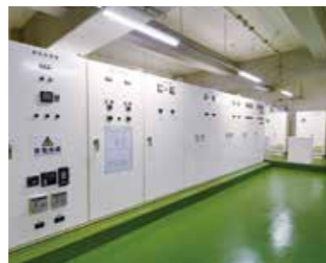
電気室 ELECTRICAL ROOM
