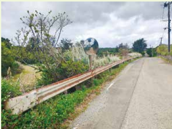
老朽化したガードレール
