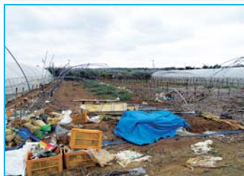
台風により破損したハウス
