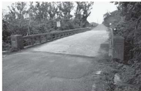
老朽化した大津勘橋
