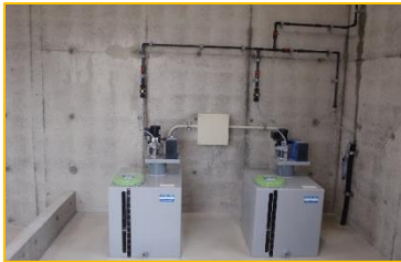
浄水場塩素投入機
