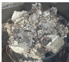
↑ 下水管につまっていた油のかたまり
