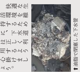
↑油詰り閉塞した下水管
