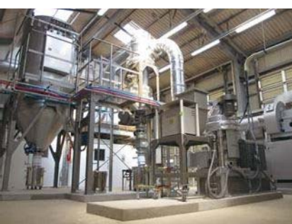
えらぶ特産品加工施設に設置されている「DMR 粉砕乾燥装置」
