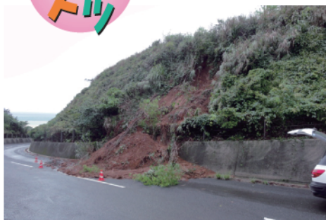
大雨後の土砂災害(沖泊漁港線 10/11)
