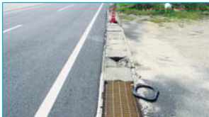
知名漁港臨港道路側溝
