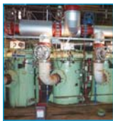
更新されるジュースヒーター
