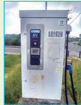
急速充電設備
