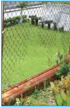
危険なフェンス
