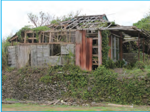
倒壊寸前の空き家対策を
