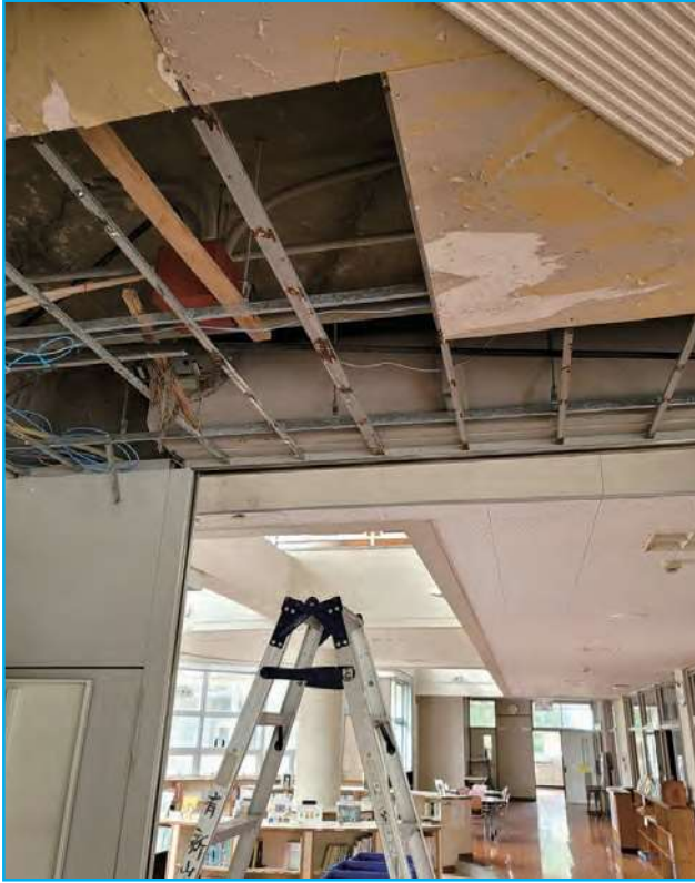
下平川小学校玄関ホールの抜本的な雨漏れ対策を
