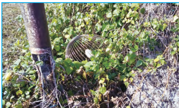
腐食破損した街灯
