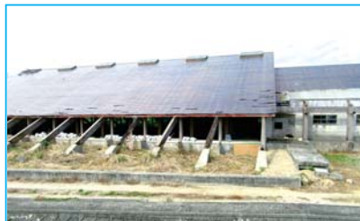
台風被害を受けた町立武道館
