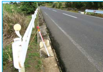
県道知名国頭線屋子母道路の早急な改修を
