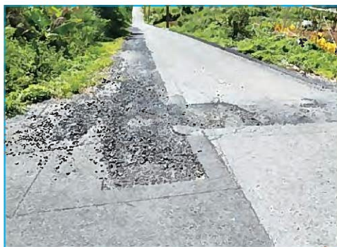
農道の補修箇所
