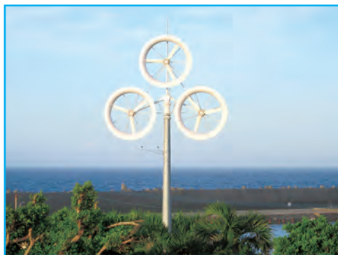
小型風力発電機 (フローラルパーク・メントマリ公園)
