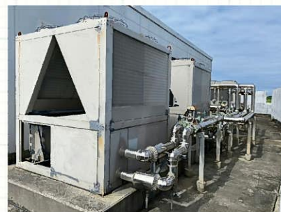
屋外に設置されている空調機器
