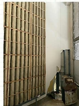
劣化したフィルタ
