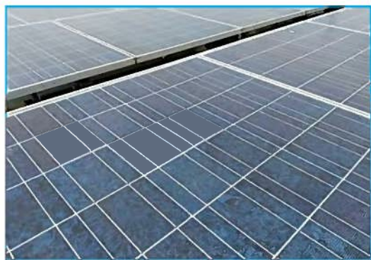
太陽光パネル
