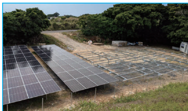
太陽光パネル 認定こども園駐車場
