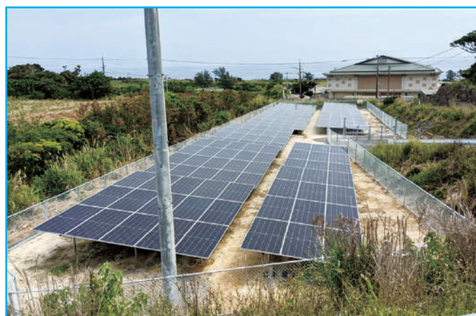
太陽光パネル 社会福祉協議会駐車場
