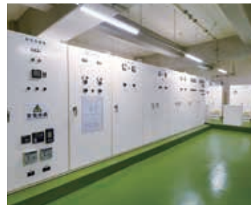
電気室 ELECTRICAL ROOM
