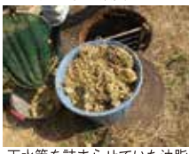
下水管を詰まらせていた油脂
