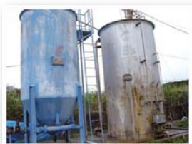
田皆急速ろ過機
