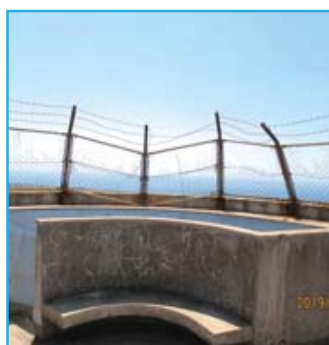
大山展望台フェンスの修繕を
