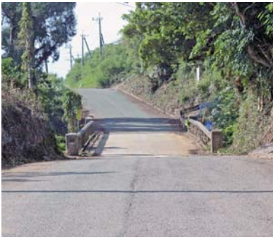
早急な整備が必要。「大津勘橋」
