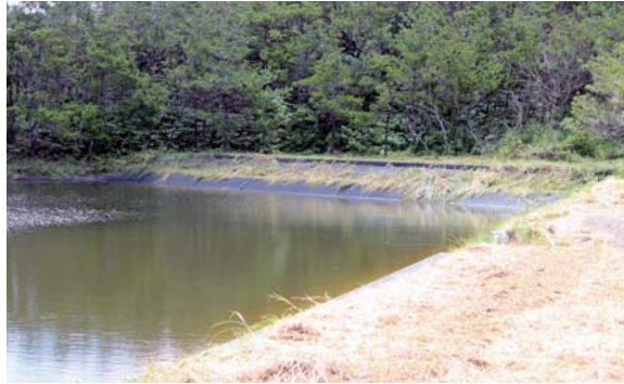
老朽化が著しい奥ため池 28年度県営事業で改修
