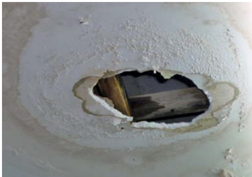
雨漏りで天井が抜けてしまった所
