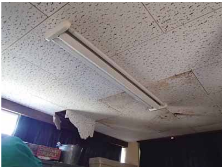
天井板が剥離して危険な田皆字公民館
