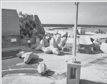
▲台風24号の被害を受け損壊した防波堤 (知名漁港)
