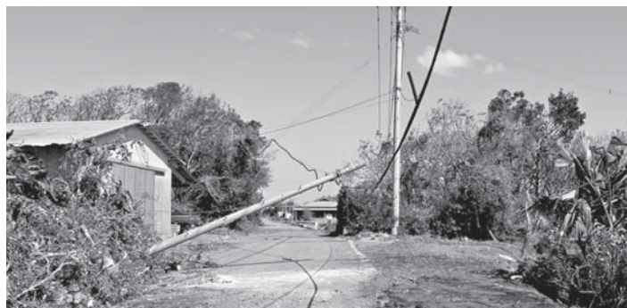
台風による電柱倒壊
