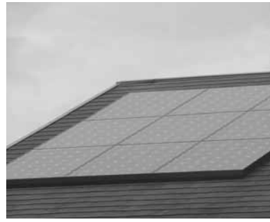
家庭用太陽光発電システム
