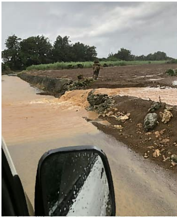
大雨による法面被害
